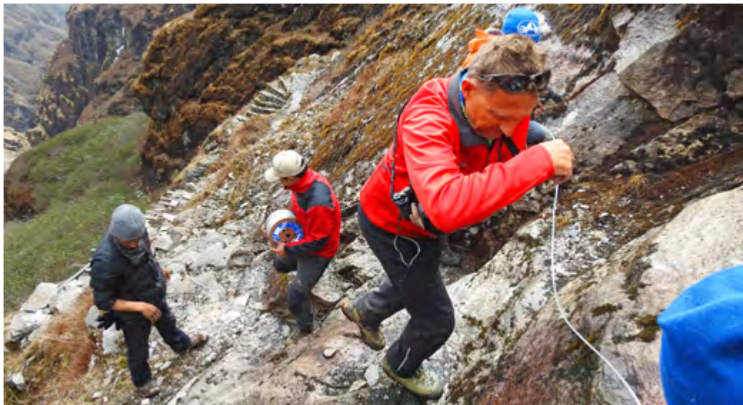
Auf 4000 m ü. M. ziehen Meinrad und die Sherpas das Stahlseil ein.
